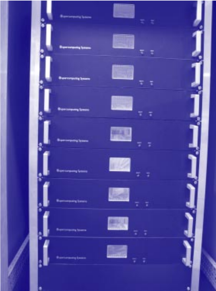
FIGURE 4: LES SWITCHES TNET, À 12 PORTS CHACUN
